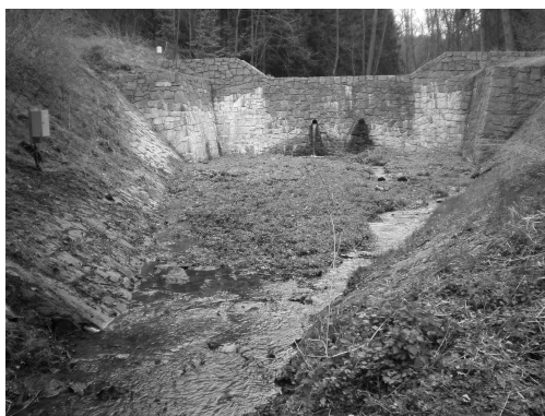
Obr. 1 Pohled na „Velkou přehrážku“ s osazenými přístroji na pravém břehu potoka
