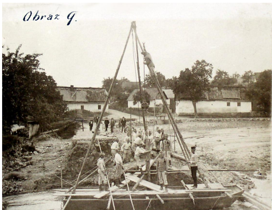
Obr. 14 Hráz Popovického rybníka protržená při povodni 1906 (zdroj: archiv obce Popovice).
