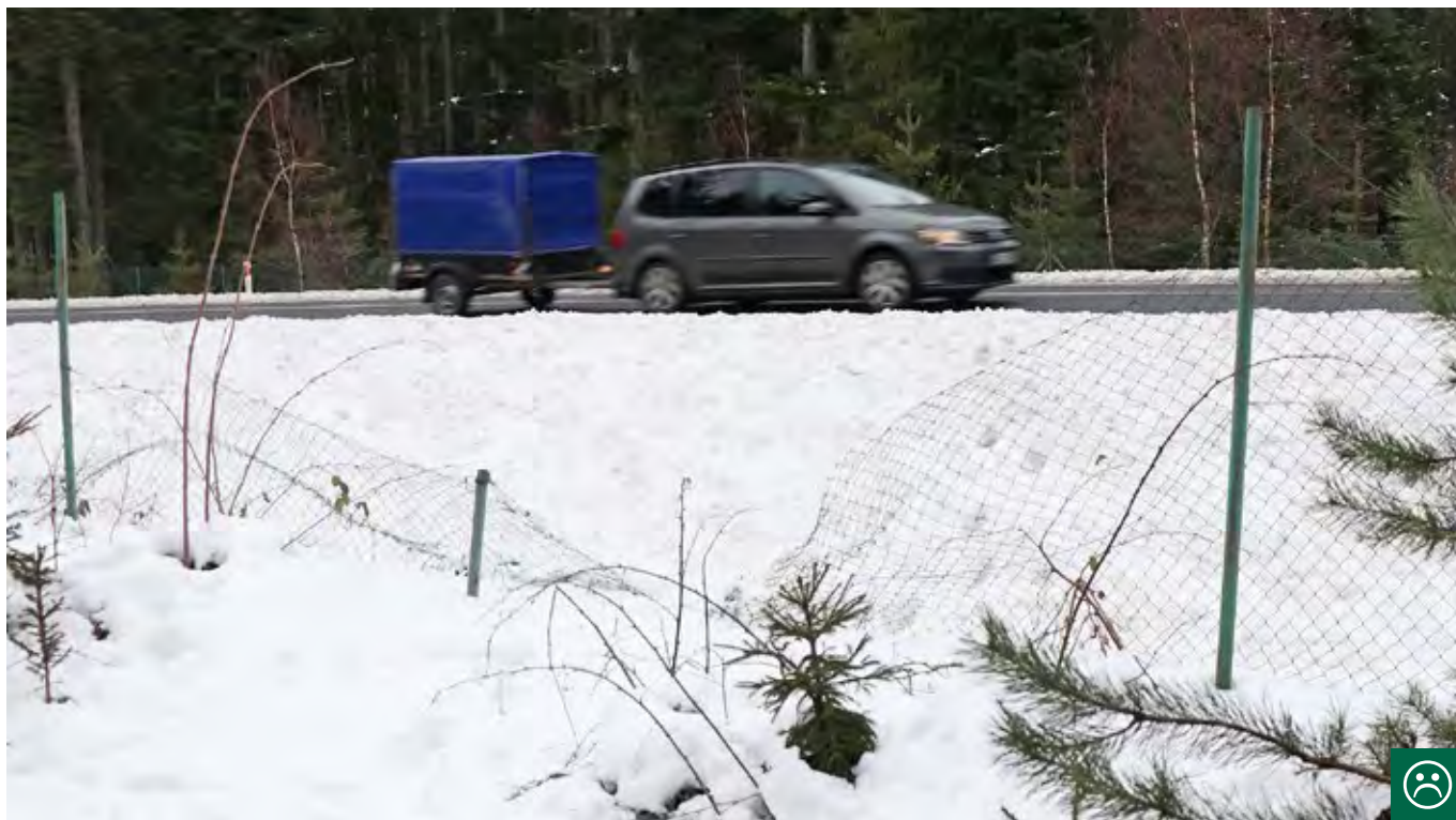
Obr. 10.48 Oplocení je často poškozené např. padlými stromy nebo po nehodách. Zvěř obvykle takoveto otvory najde velmi rychle a dostává se tak do nebezpečné oblasti uvnitř oplocení. V případě vyrušení pak vyběhne přímo na komunikaci a stává se obětí dopravy. (© Václav Hlaváč)
