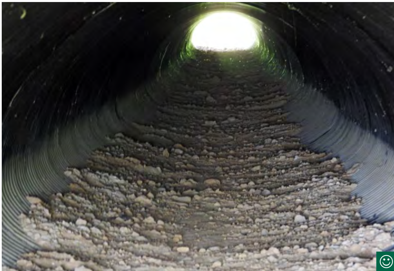
Obr. 10.28 Dno ocelového propustků “Tubosider” je pro většinu živočichů nepřekonatelné. Po přesypání dna zeminou se však propustek stává dobře průchodným pro většinu druhů. (© Otakar Kozák)
