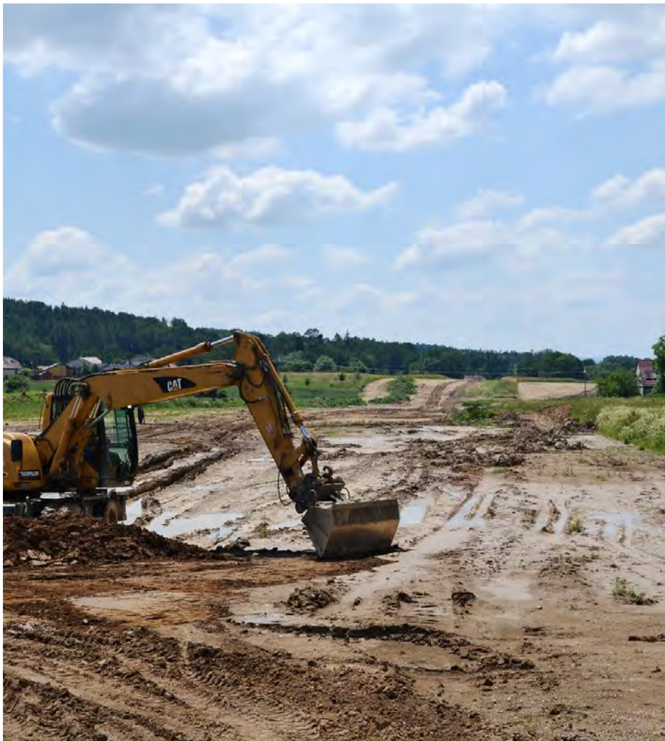
Obr. 4.1 S výstavbou dopravní infrastruktury je vždy spojená přímá ztráta stanovišť. Při hodnocení vlivu výstavby je však nutné brát v úvahu i další dopady, které mají navíc často kumulativní charakter. (© ŘSD)
