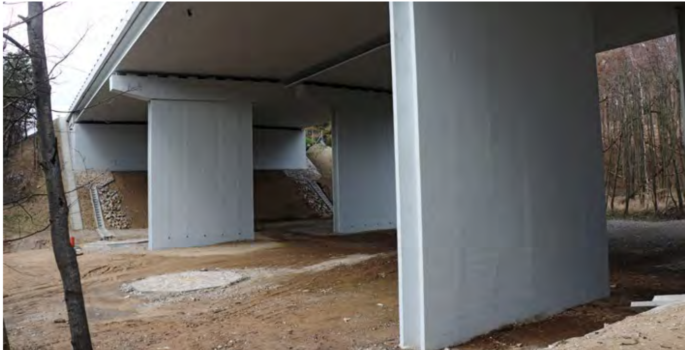
Obr. 9.7 Optimálním řešením pro překonání drobných údolí je dostatečně velký most. Pokud je prostor pod mostem ponechán bez technického zpevnění, není nutné realizovat žádné vegetační úpravy, ozelenění zde proběhne velmi rychle a samovolně podle světelných a srážkových podmínek pod mostem (nově rekonstruovaný most na dálnici D1). (© Václav Hlaváč)
