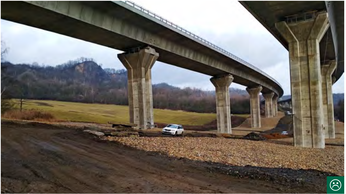
Obr. 10.1 Funkčnost podchodů významně ovlivňuje úprava povrchu pod mostem. Optimální je vždy nezpevněný povrch umožňující rozvoj vegetace. Štěrkový nebo oblázkový povrch je nevhodný, při pohybu vytváří hluk, proto se mu zvířata většinou vyhýbají. (© Lenka Libichová)
