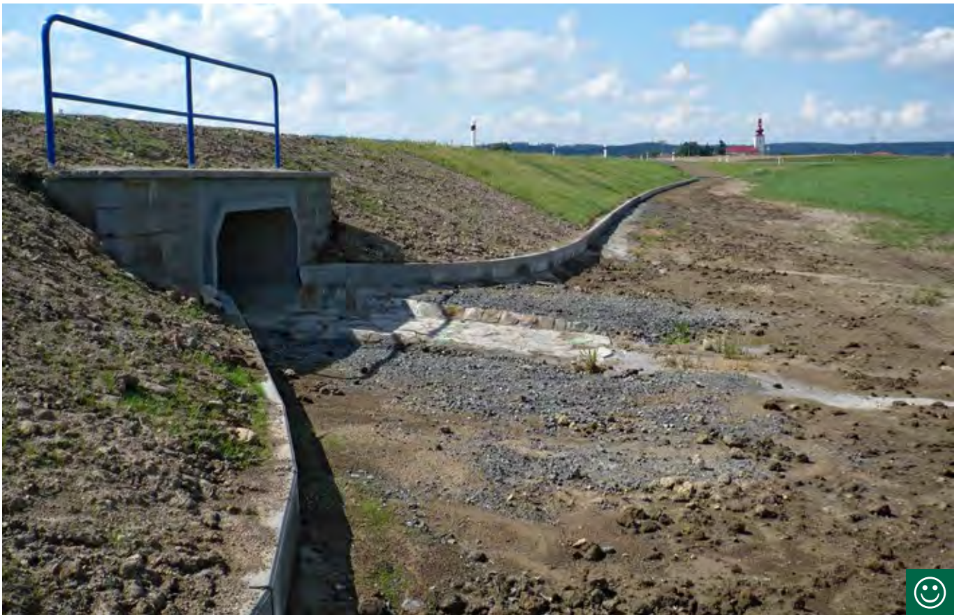
Obr. 10.71 Trvalé zábrany mají za cíl navedení migrujících obojživelníků ke vhodným podchodům. Vždy se budují na obou stranách komunikace – ve směru jarní migrace do vodních biotopů a též směrem zpět do biotopů suchozemských. (© Jaromír Maštera)
