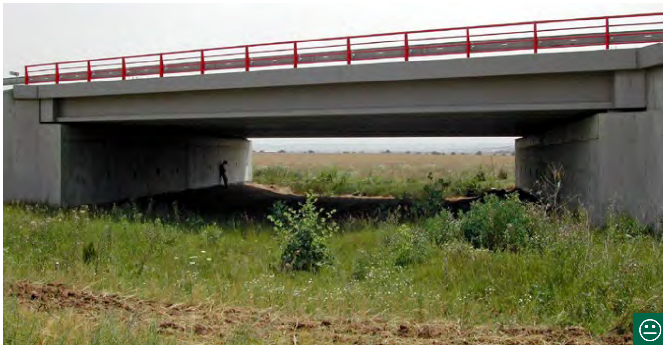
Obr. 10.39 Speciální most je budovaný výhradně k umožnění migrací živočichů. K dosažení maximální účinnosti by bylo vhodné doplnit naváděcí zeleň, protihlukové stěny a minimalizovat hlučnost mostních závěrů. (© archiv AOPK ČR)
