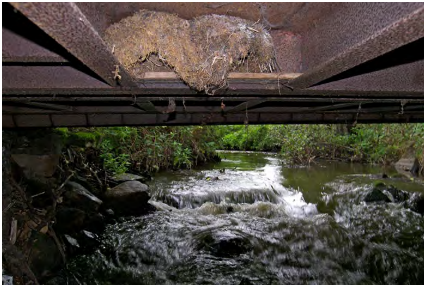
Obr. 6.14 Mosty mohou poskytovat dobré podmínky pro hnízdění skorců vodních. (© Vojtěch Kodet)
