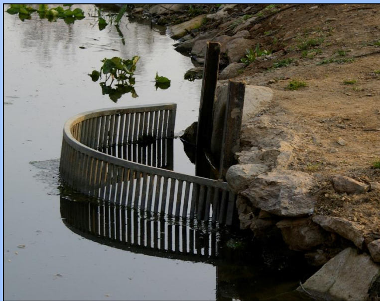
MVN v obci Staré Bříště (okr. Pelhřimov)
