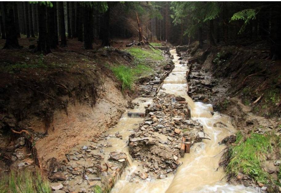
Poškozená lesní cesta
